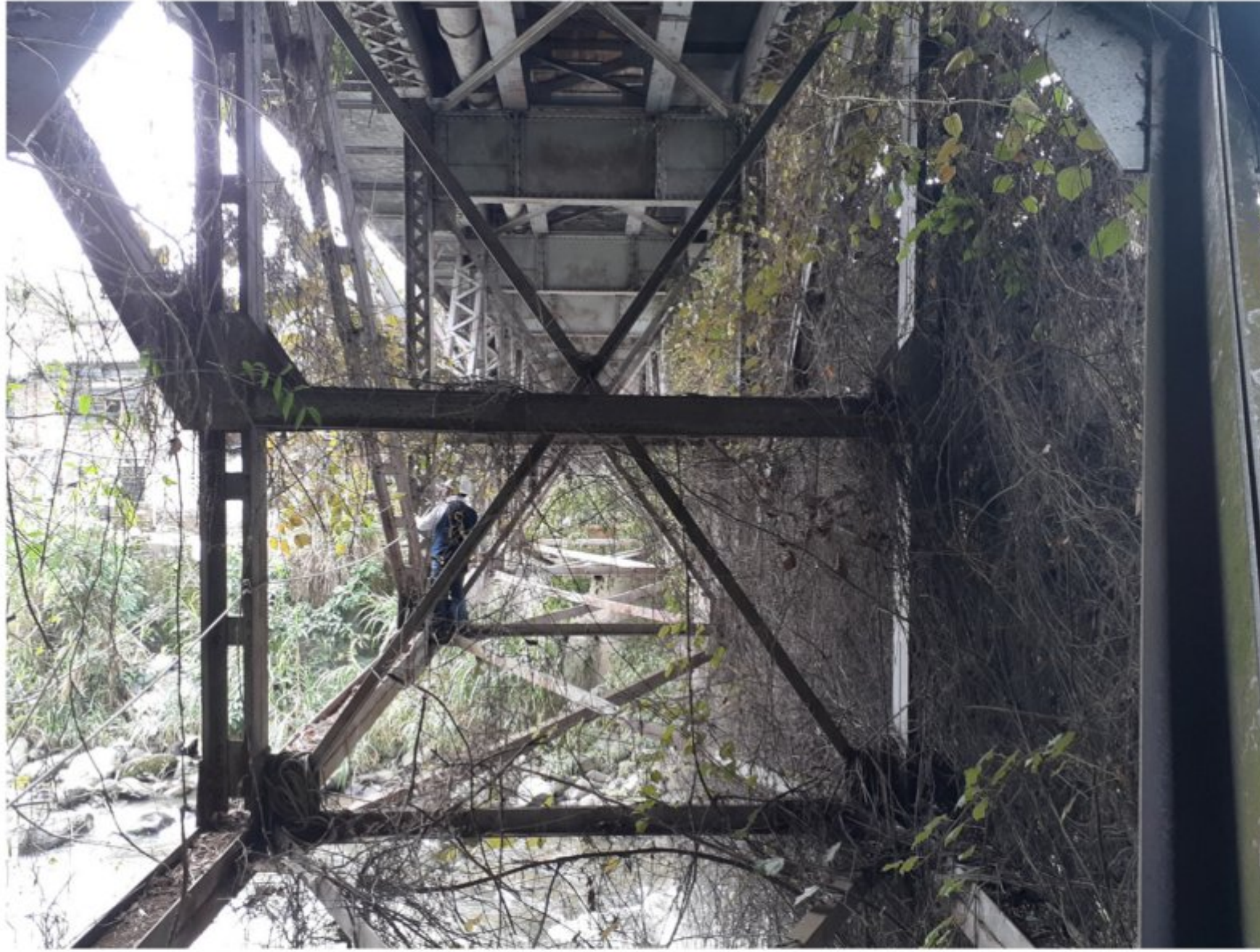
Imagen 1: Estado actual del puente, con invasión de plantas y ataque de agentes biológicos y atmosféricos.
