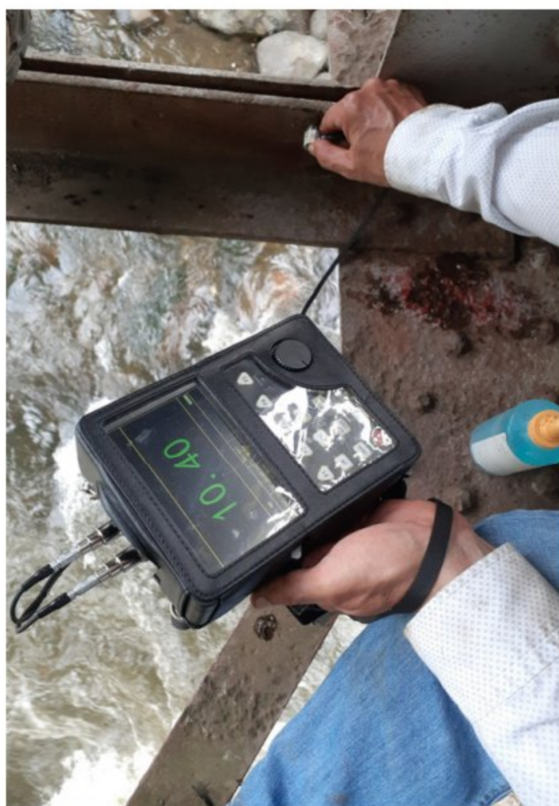
Espesor sin Afectación Por Corrosión 10.40 mm
