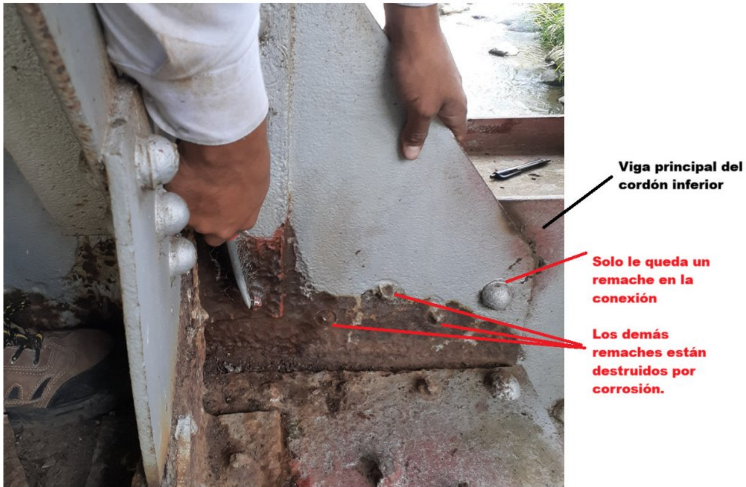
Imagen 5: Pérdida de integridad estructural en la conexión por corrosión.
