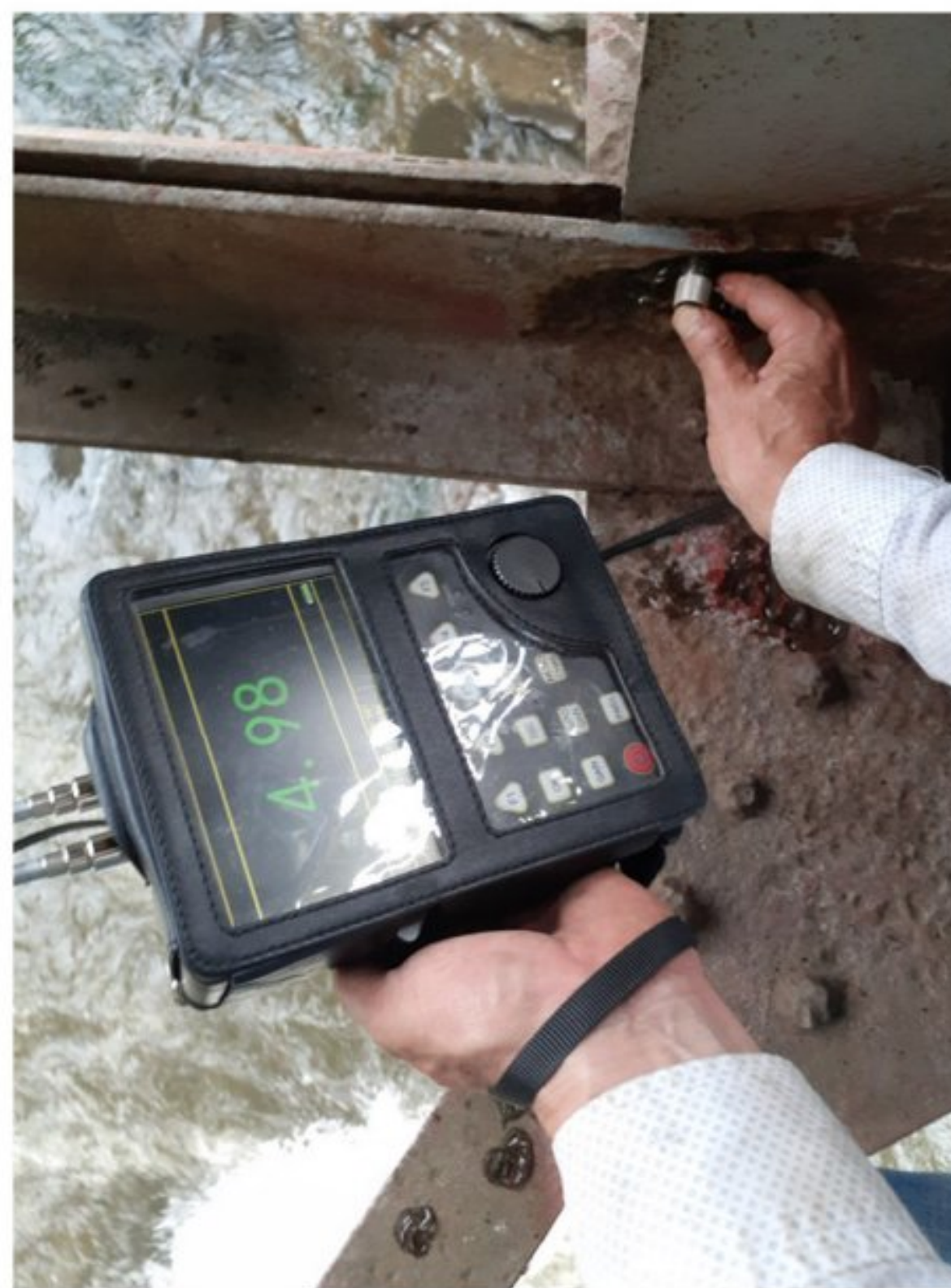
Espesor en la misma pieza en zona afectada por Corrosión (Pérdida del 52% de la sección transversal)
